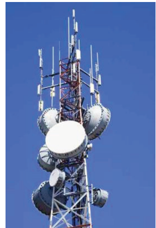
Fig. 22. Gruppo di antenne per telecomunicazioni.
