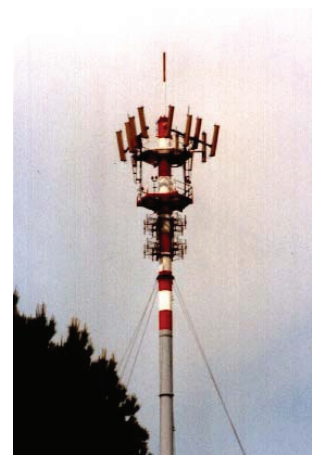
Fig. 26. Una stazione radio base (SRB).
