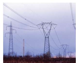
Fig. 23. Linee elettriche ad alta tensione.
